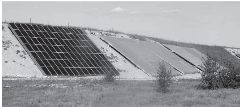
Elementy nowoczesnej ciepłowni
